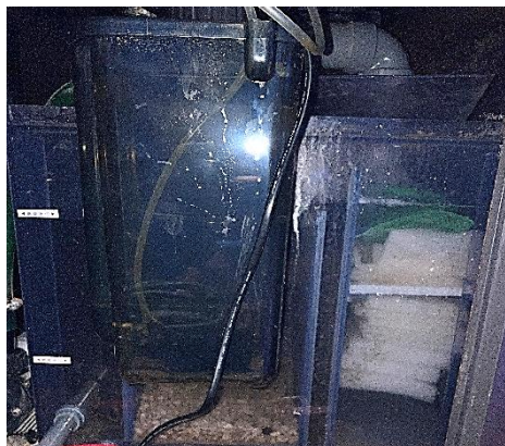
写真 4. 円形水槽②のろ過槽（改善後）
